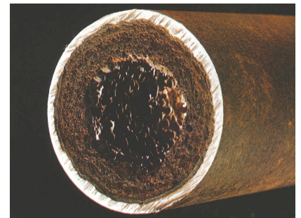
Tubería metálica en un avanzado proceso de sedimentación
